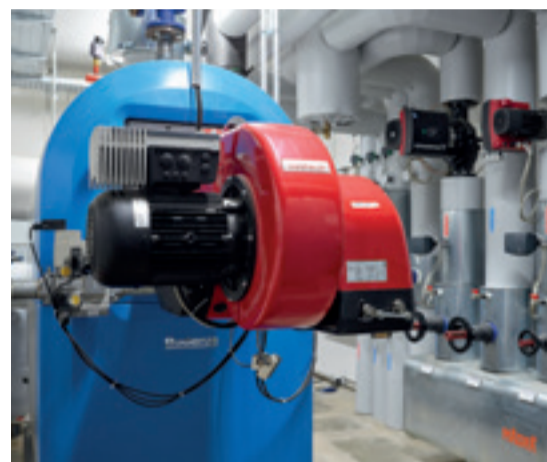
Kesselblock mit Brenner
