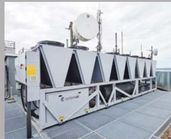
Kältemaschine zur Kühlung der Büros und Serverräume
