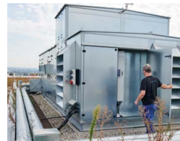
Die Kältemaschine auf dem Dach
