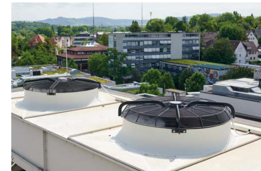
Rückkühlwerk auf dem Dach der Zentralklinik
