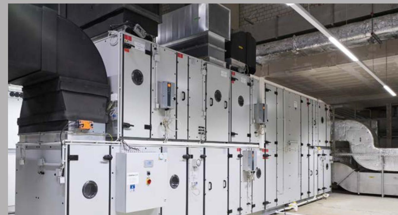
Lüftungsgerät für die Kantine mit integrierter Kälteerzeugung
