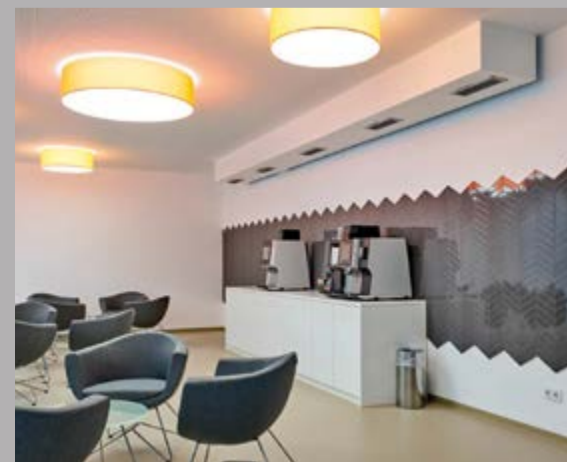
Zentrale Absaugung der Luft
