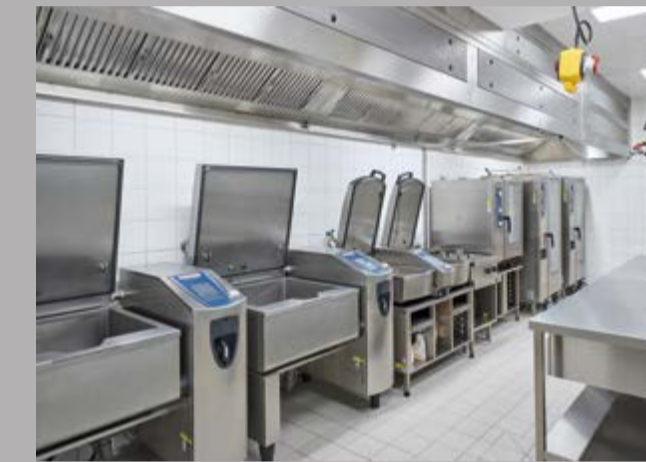
Dunstabzugshauben mit aufgesetzten Zuluftelementen
