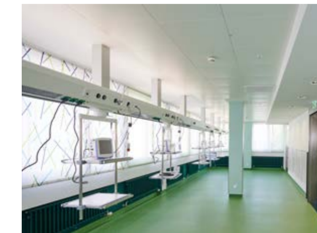
Aufwachraum mit Medienversorgung
