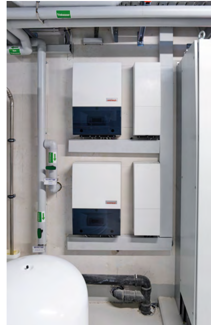
Steuereinheiten der Wärmepumpen
