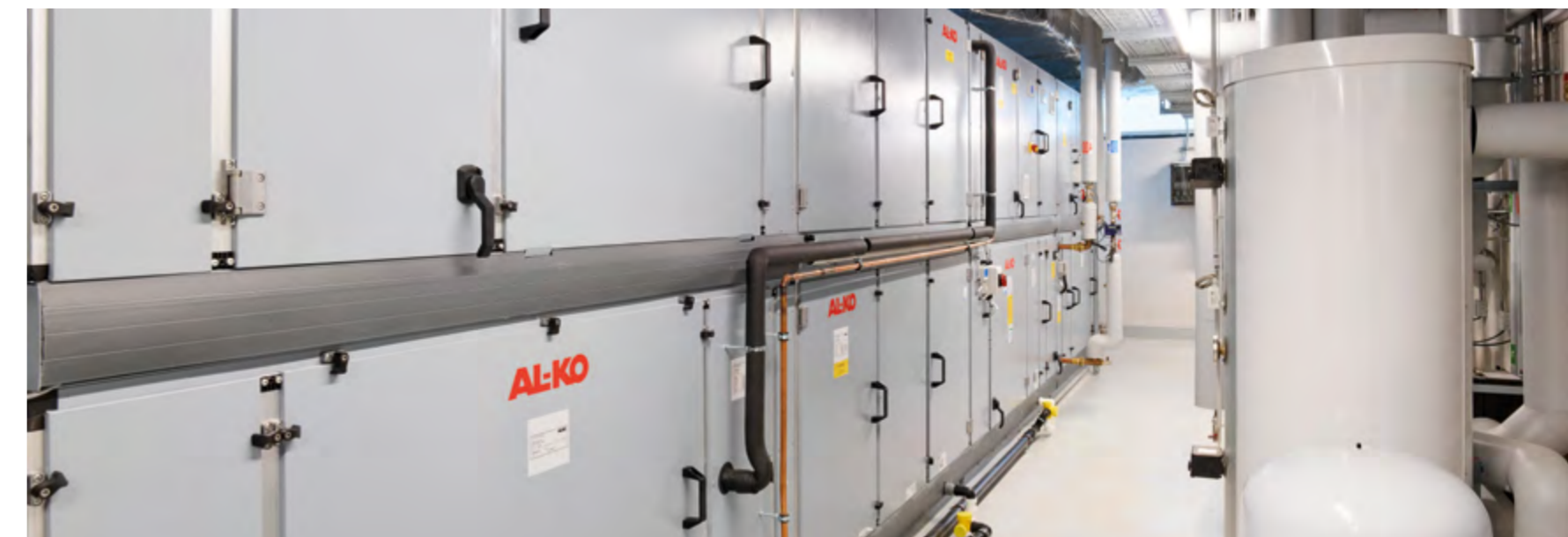
Der Technikraum des Gebäudes mit Lüftungsanlage im Bildvordergrund
