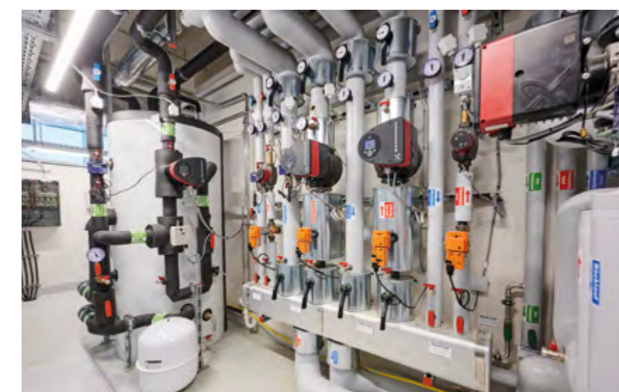
Heizungs- und Kälteverteiler mit Pufferspeicher
