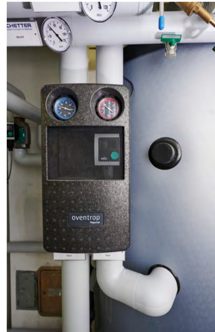
Pumpenmodul der Solaranlage
