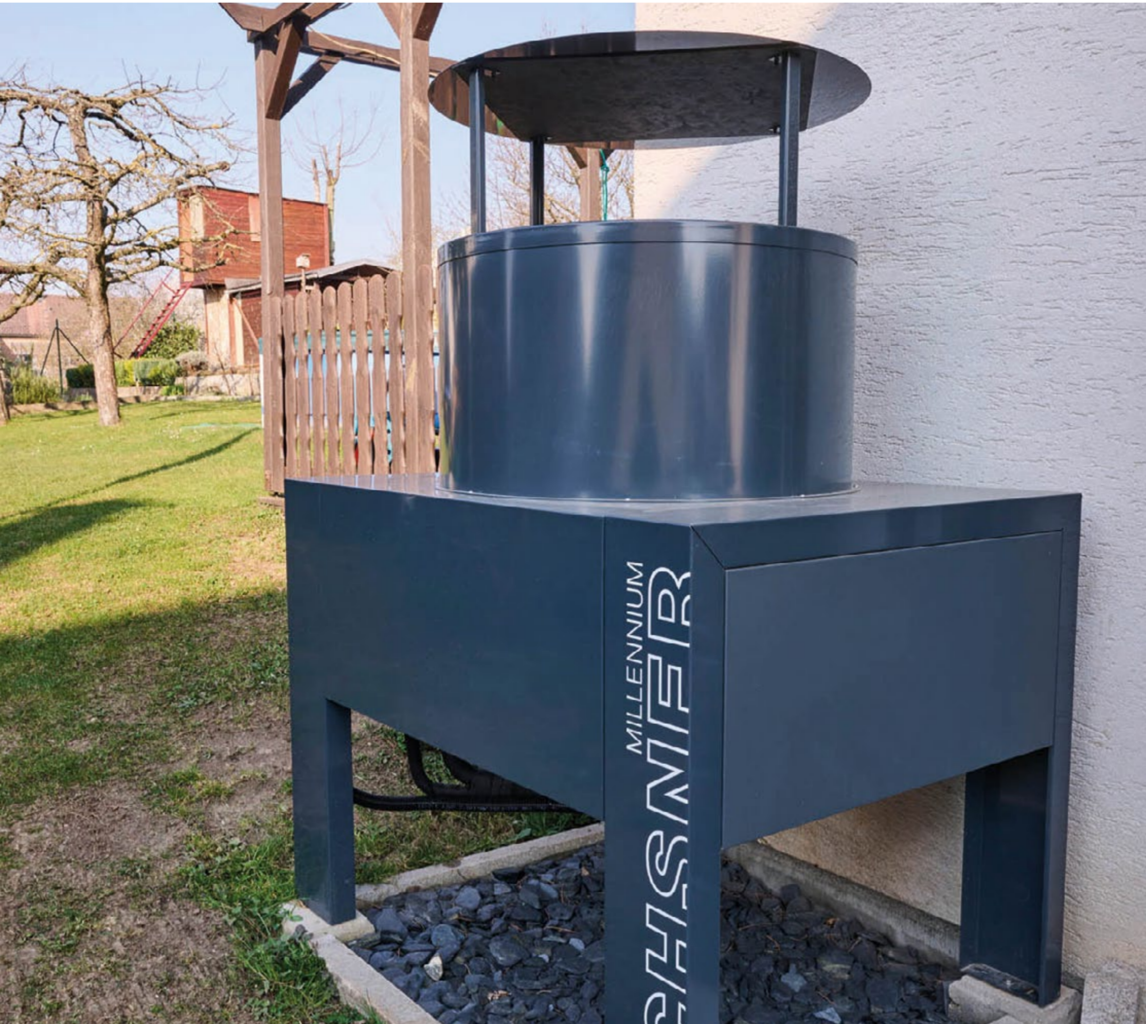
Der Splitverdampfer der Wärmepumpe ist derzeit das leiseste Modell am Markt.
