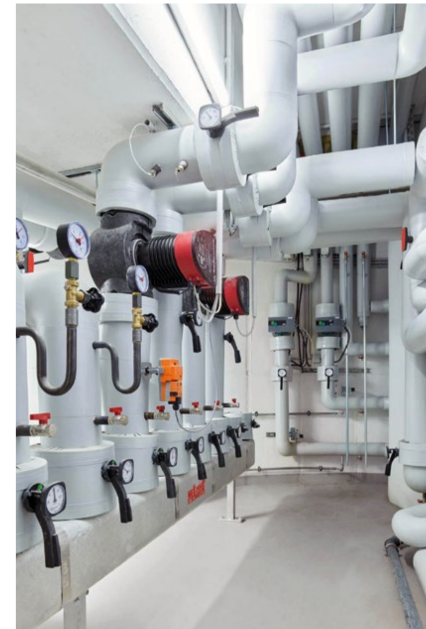
Blick in die Technik-Zentrale im Untergeschoß.
