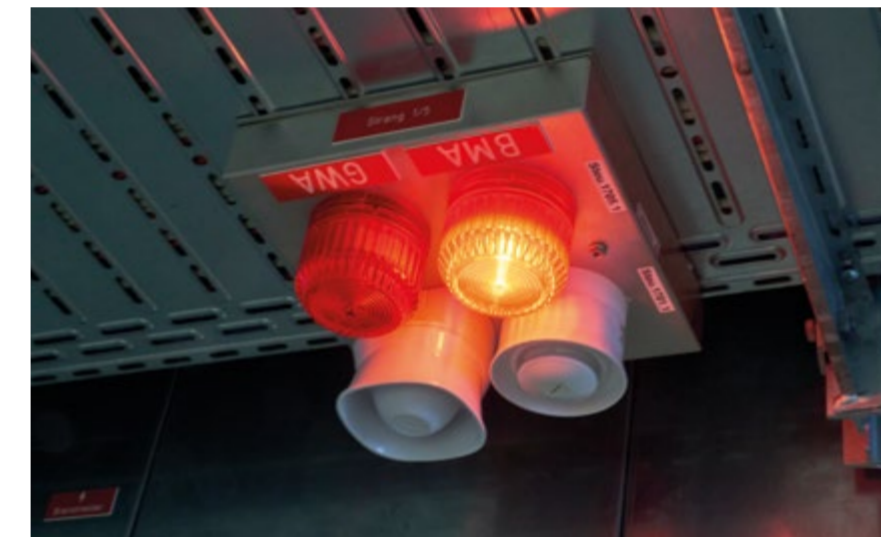
Löst die Brandmeldeanlage richtig aus?
