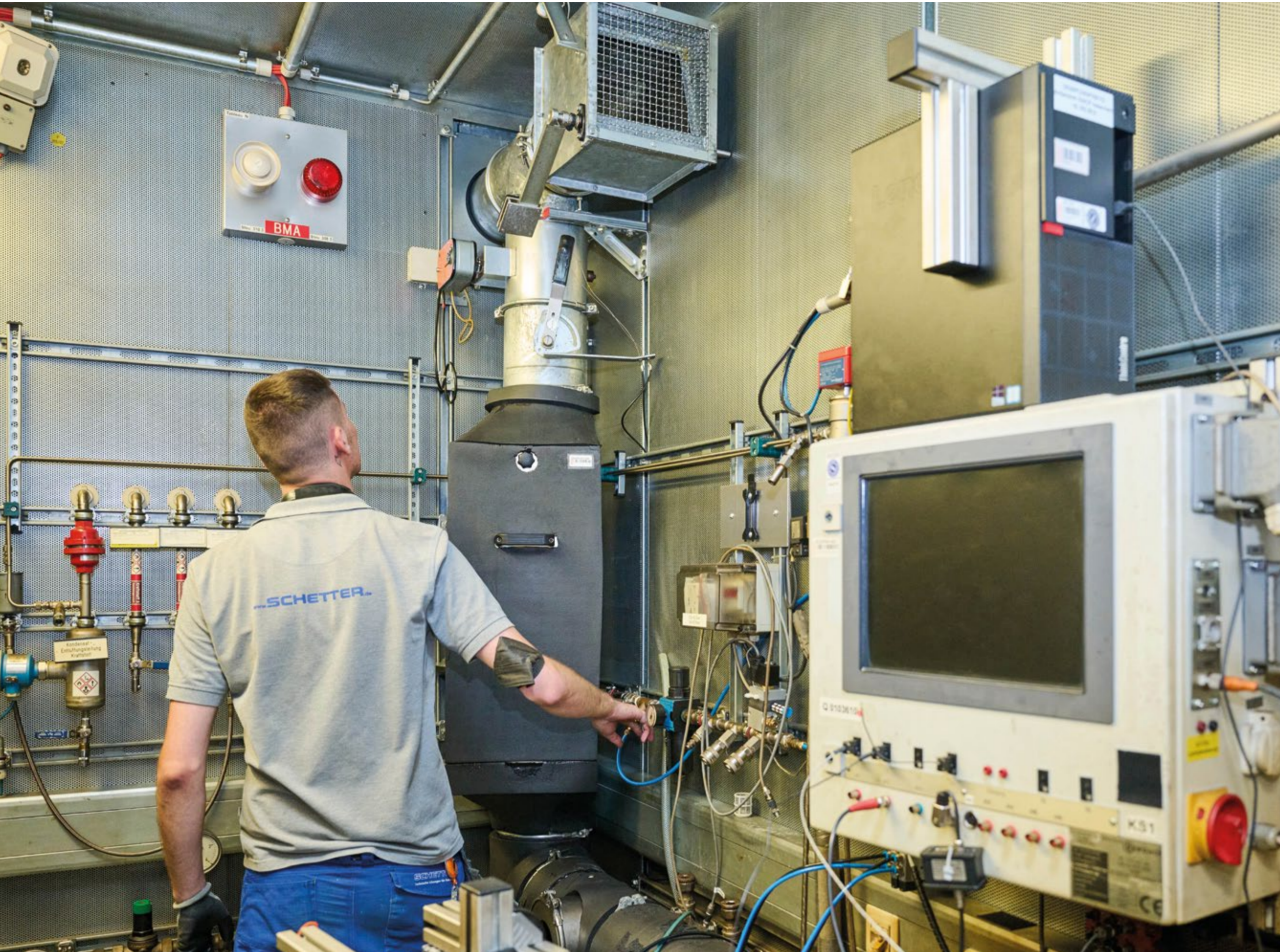
Überprüfung, ob die CO 2 -Überdruckklappe zur Absaugung auf- und zugeht
