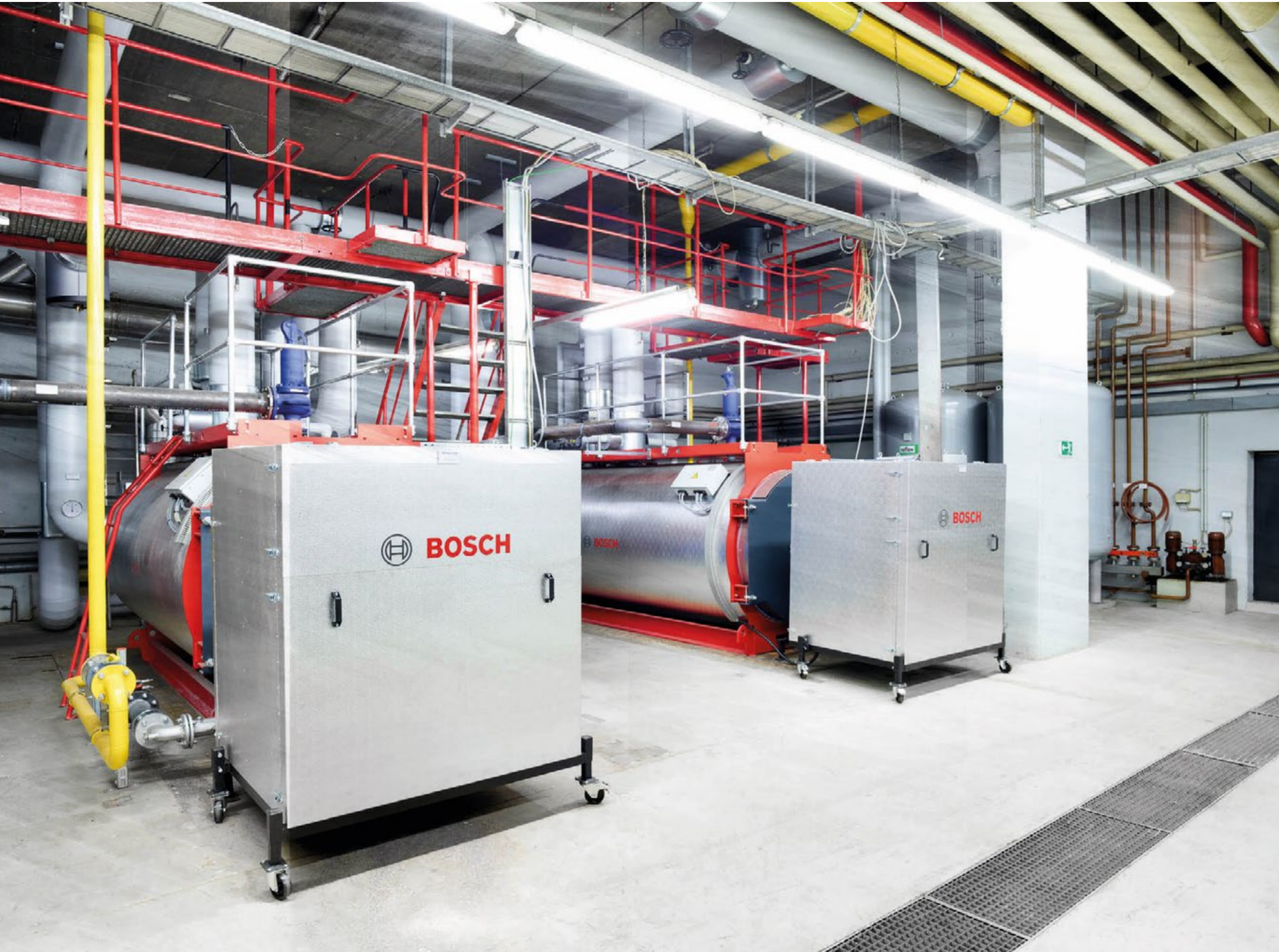
Die beiden neuen Gaskessel mit jeweils 3,2 Megawatt Leistung
