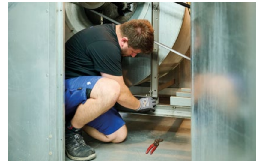
Notwendige Reparaturarbeiten am Lüftungssystem
