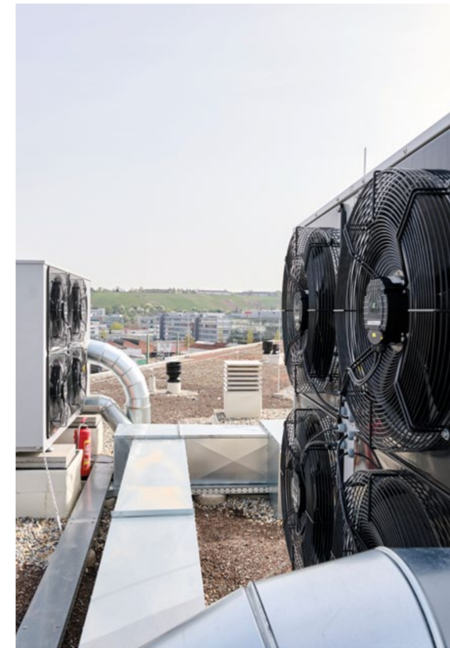
Rund 65 % des benötigten Wärmebedarfs kommen aus der Umgebungsluft.
