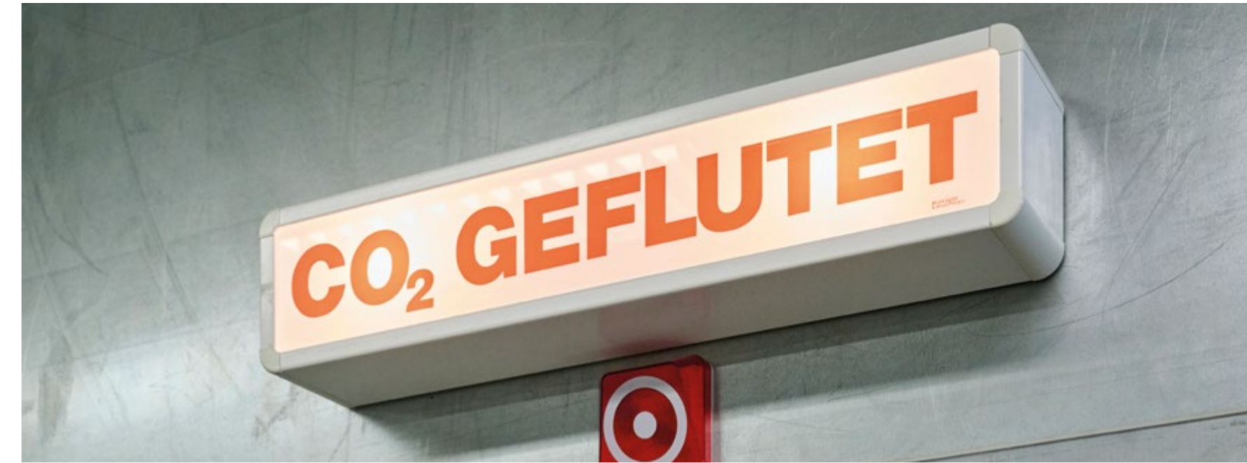
Beim Betrieb der CO 2 -Löschanlage zeigt ein Warmmelder an, dass die Anlage im Löschbetrieb ist.
