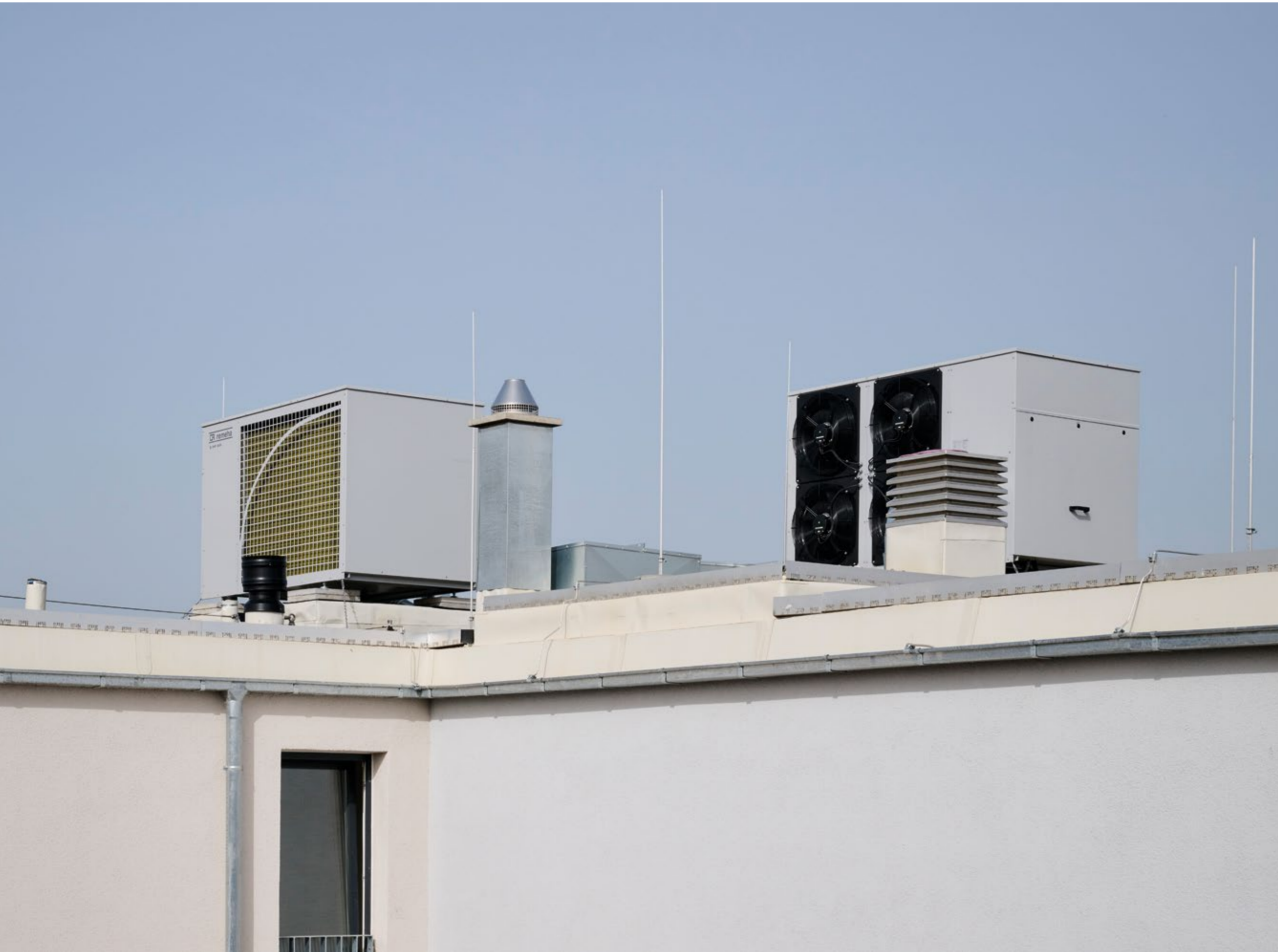
Die beiden Luft-Wasser-Wärmepumpen auf dem Dach des Gebäudes
