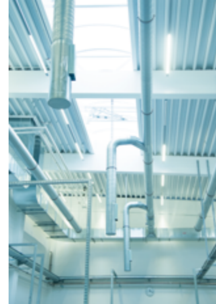
Lüftungs-Quellauslässe in der Produktion
