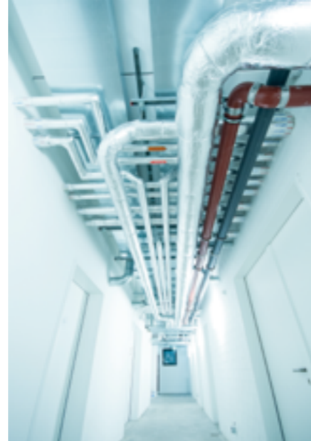
Medientrassen im Untergeschoss
