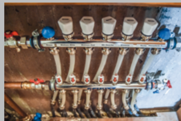
Modernisierter neuer Heizkreisverteiler
