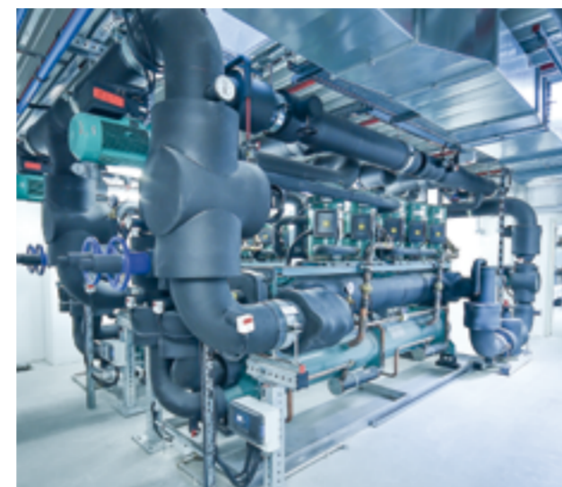
Die große Kältemaschine in der neuen Technikzentrale
