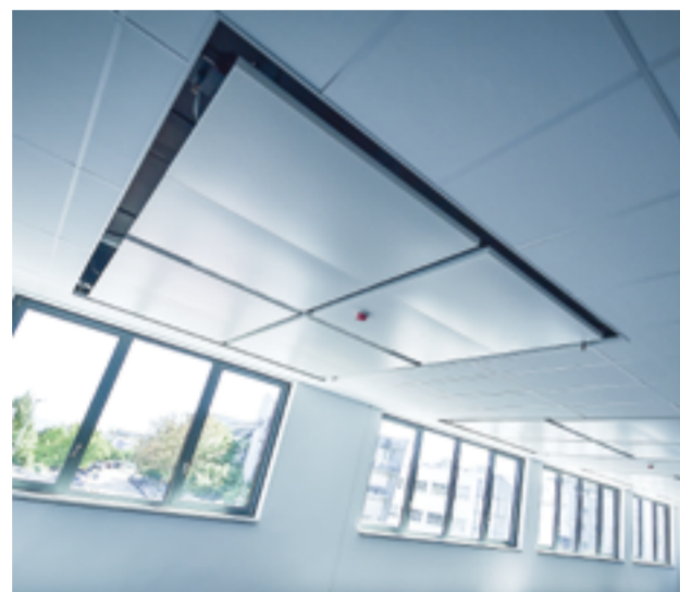
Kühldecke für die Klimatisierung im Sommer
