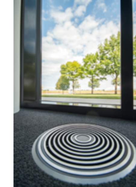
Lüftungs-Bodenauslass im Konferenzraum
