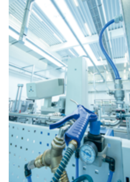
Druckluftversorgung der Arbeitsplätze
