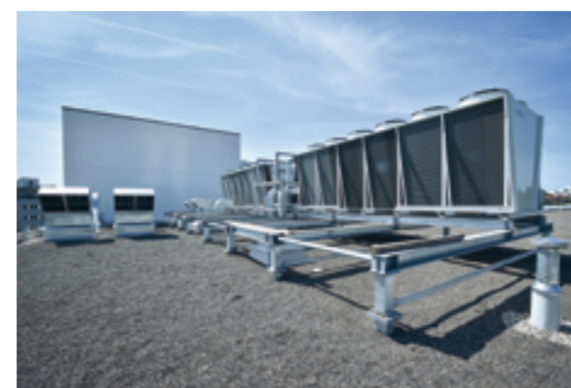
Das Rückkühlaggregat auf dem Dach
