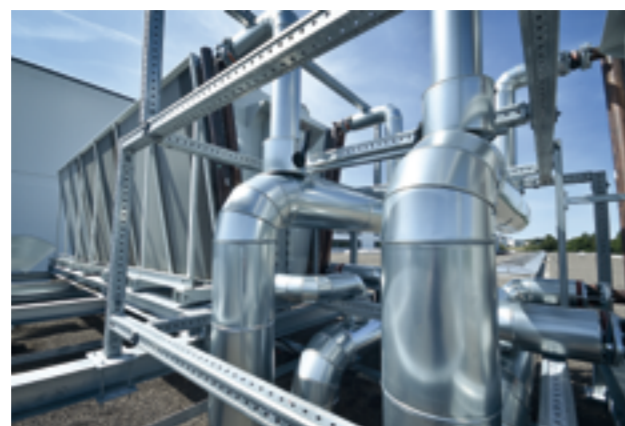
Verrohrung der Kälteanlage
