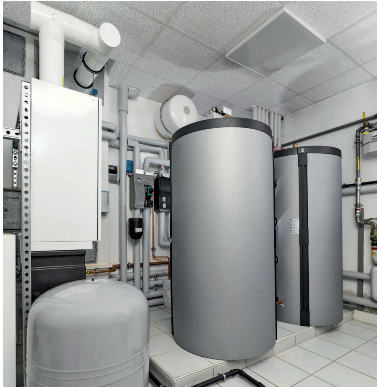
Die aufgeräumte Technikzentrale mit den beiden Pufferspeichern
