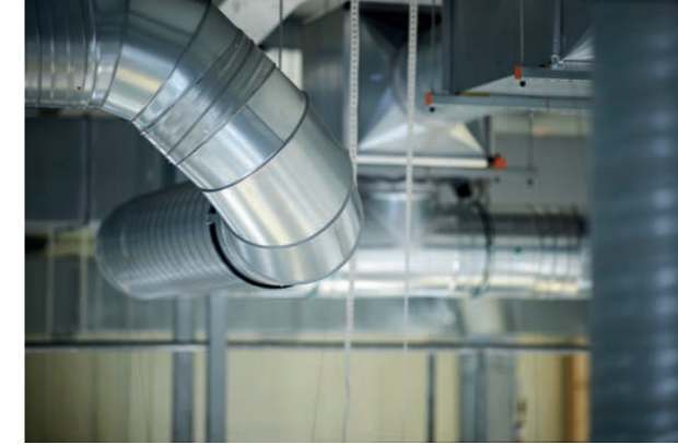
Lüftungskanäle unterhalb des Hallendachs
