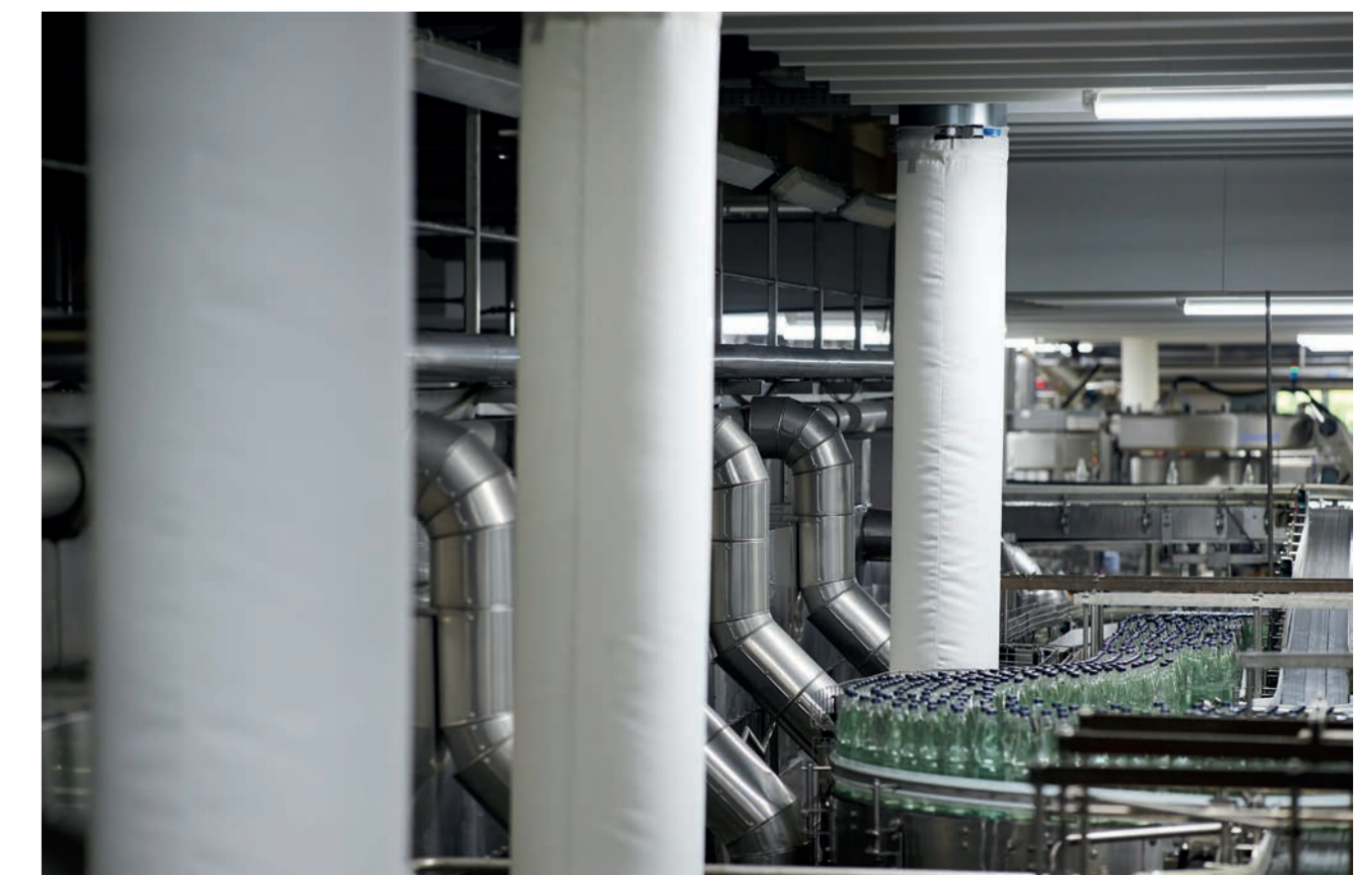
Zuluft einbringung über textile Quellluftauslässe, die an den Wärmequellen der Abfüllmaschinen angebracht sind
