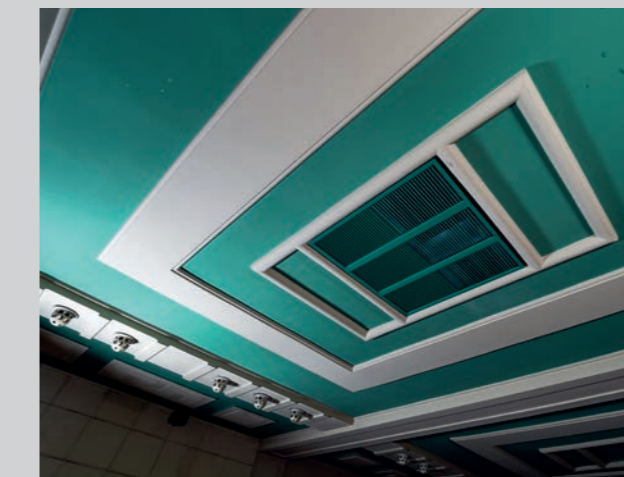
Abluft und Zuluft über die Decke des Saales
