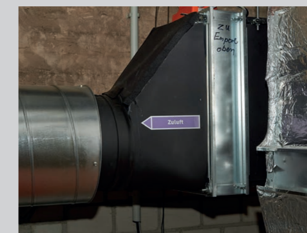
Luftklappe und Antrieb im Zuluftkanal
