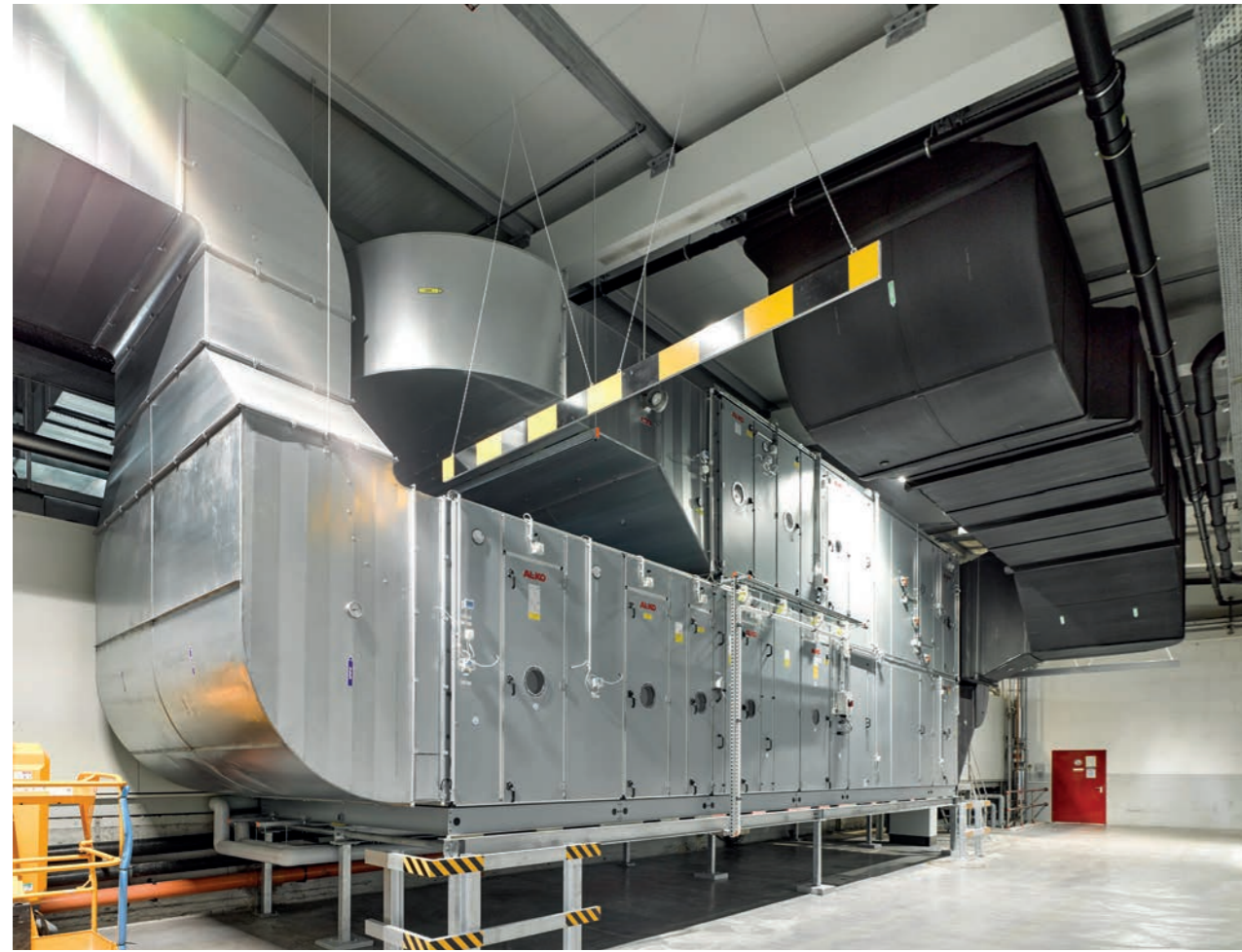
Kombiniertes Zu- und Abluftgerät für die Glashalle
