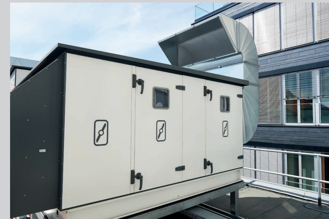
Das neue Klimagerät auf dem Dach des Central Kinos
