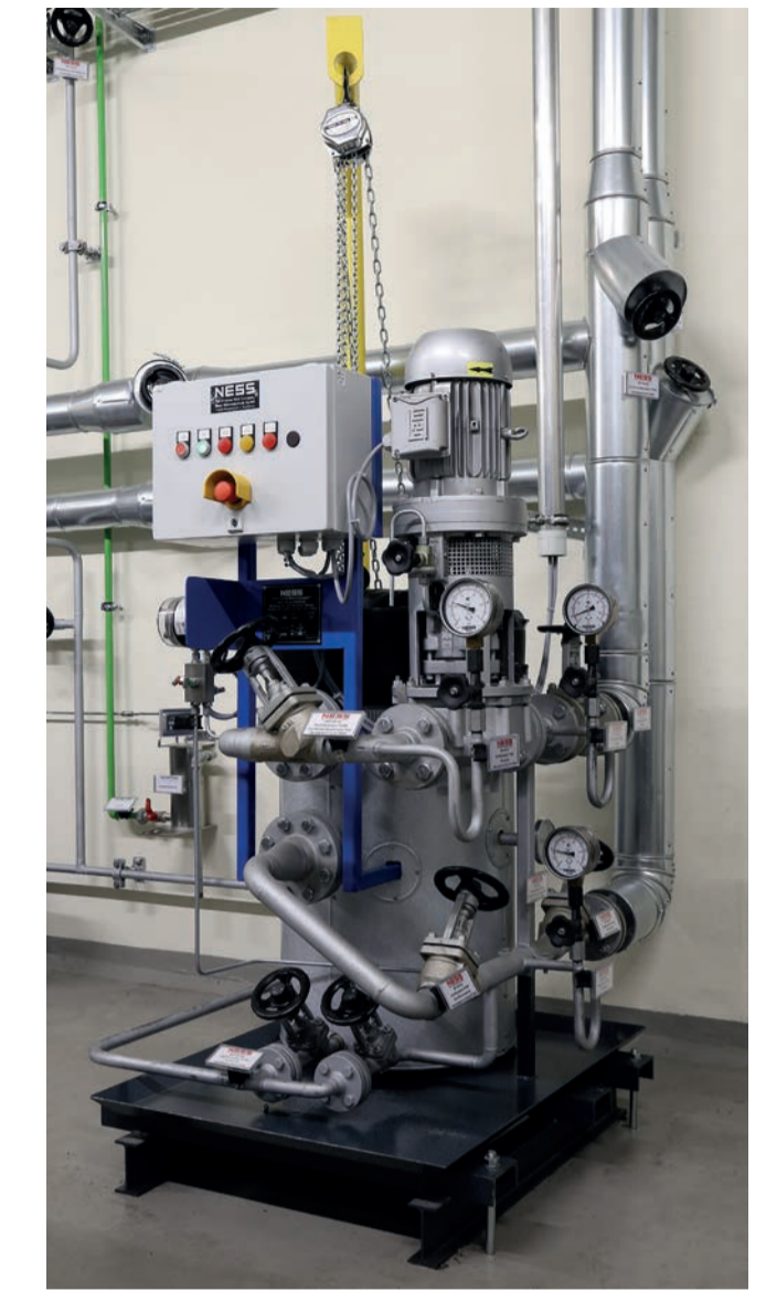
Feinfilterstation zur Reinigung des Öls
