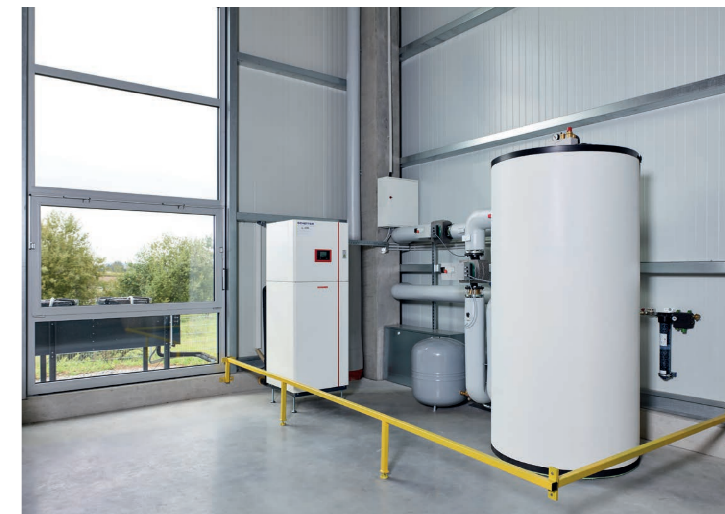
Wärmepumpe mit Pufferspeicher und einem Horizontal-Split-Verdampfer im Außenbereich
