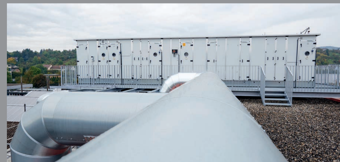
Das neue Lüftungsgerät mit Wärmerückgewinnung
