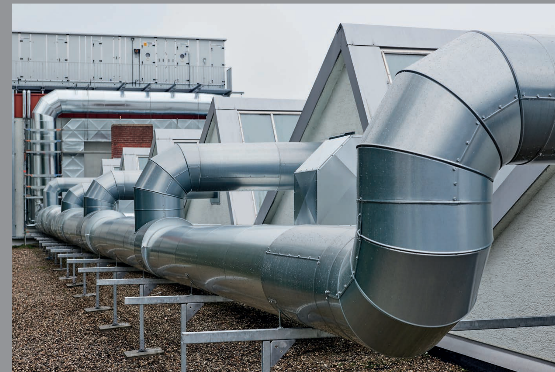
Zuluft- und Abluftkanäle auf dem Dach der Produktionshalle
