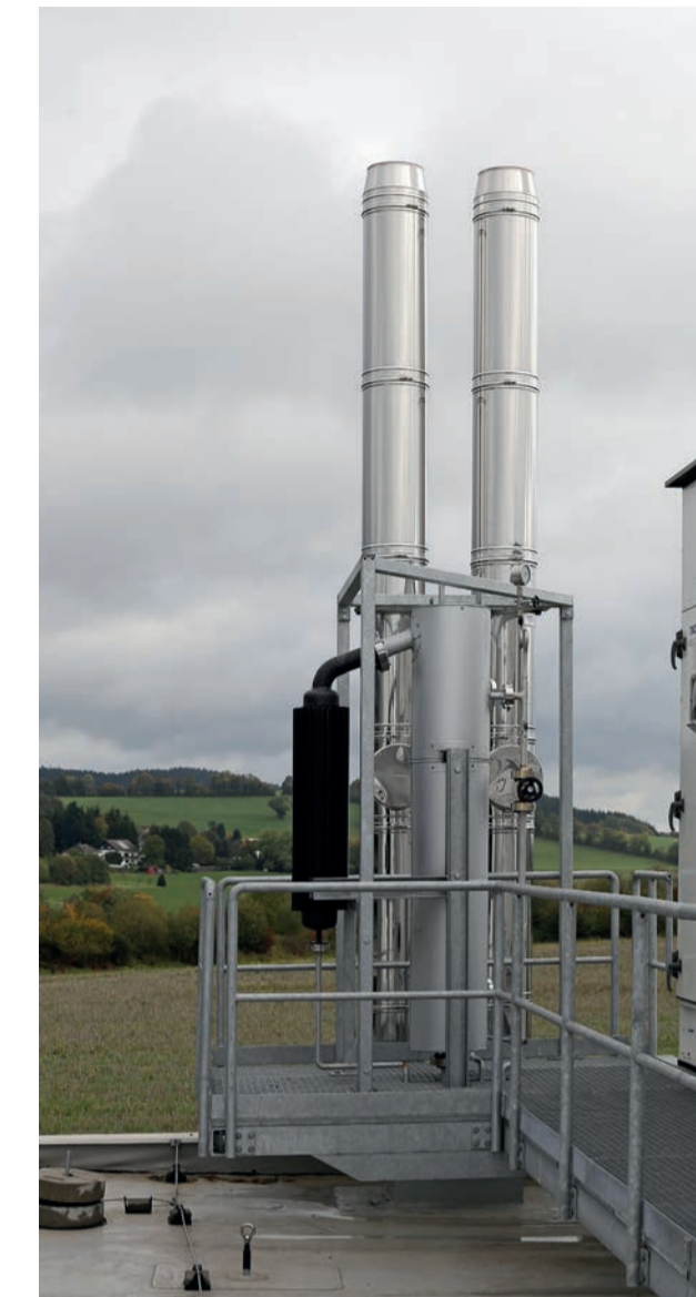
Leichtsiederstation und Kaminanlage
