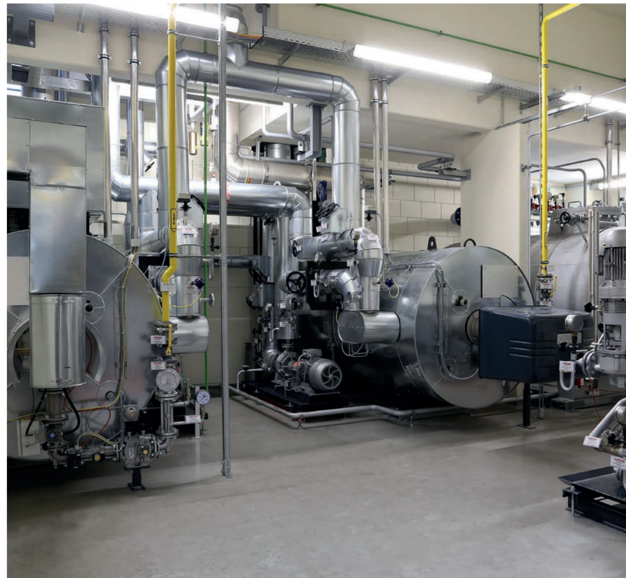
Kesselanlage, bestehend aus zwei redundanten Heißölkesseln mit einer Leistung von je 630 Kilowatt
