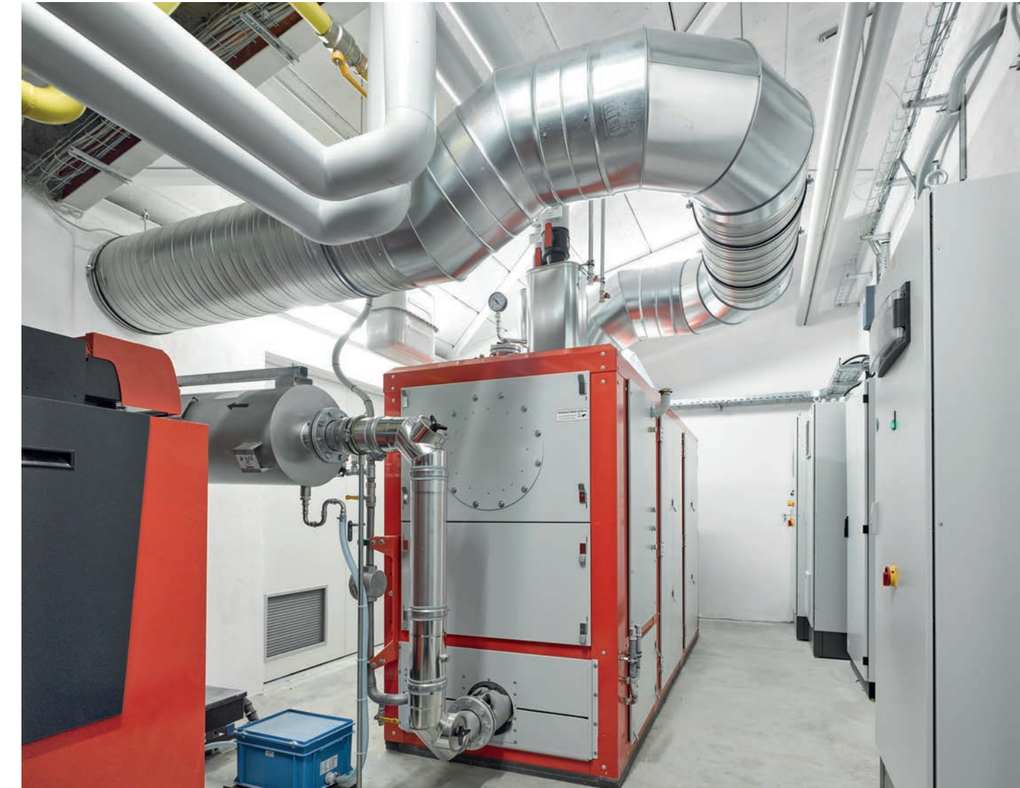
Das neue Blockheizkraftwerk in der aufgeräumten Technikzentrale
