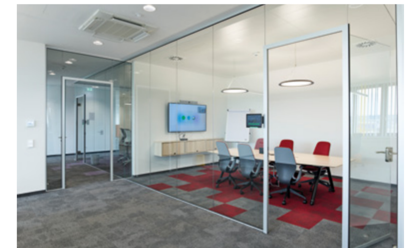
Ordentlich in die Decke integrierte Lüftungs- und Klimatechnik
