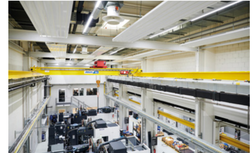
Neu installierte Decken-Heiz-, Kühl- und Lüftungssysteme in der Entwicklung
