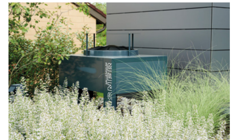
Luftwärmepumpe von Ochsner zur Temperierung des Beckens
