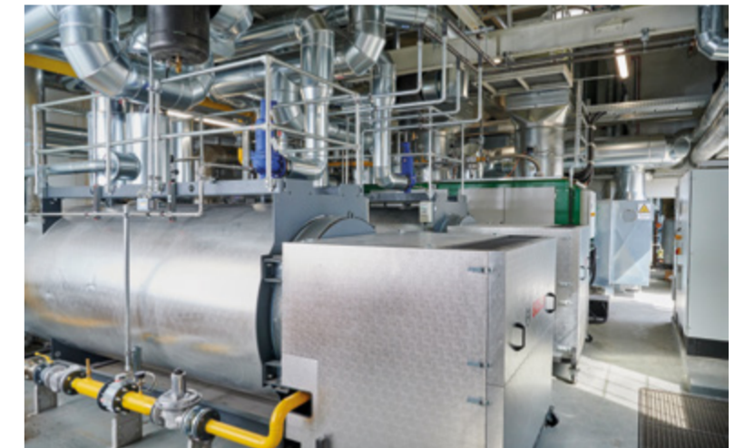
Heizzentrale mit Blockheizkraftwerk
