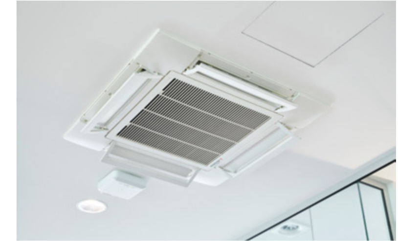
Deckenkassette mit Komfortpaneelen
