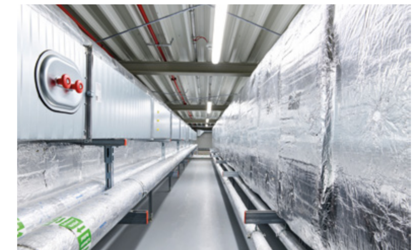
Einblick in die Energiezentrale
